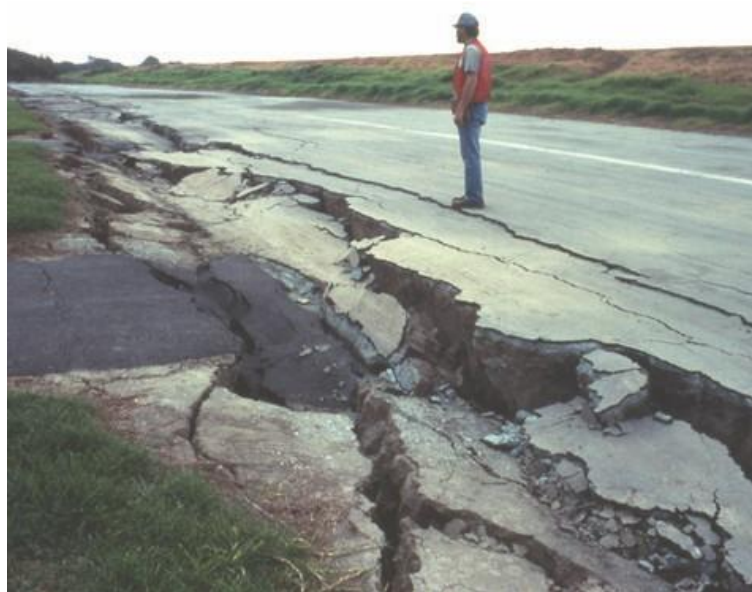
Gambar 2.11 Foto kerusakan longsoran Lateral pada jalan raya akibat gempa bumi Loma Prieta, California, Amerika Serikat, tahun 1989. (Foto oleh Steve Ellen, U.S. Geological Survey) dalam (Highland L.M et al , 2008)
