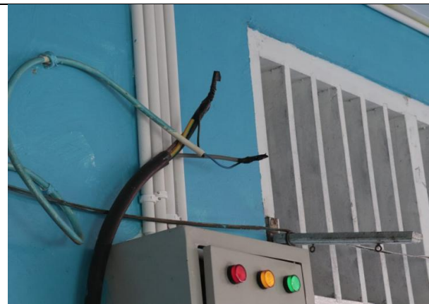
1. 14 Terminal listrik tidak tertata
