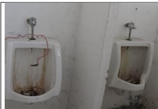
1. 15 Toilet laki-laki kurang terawat
