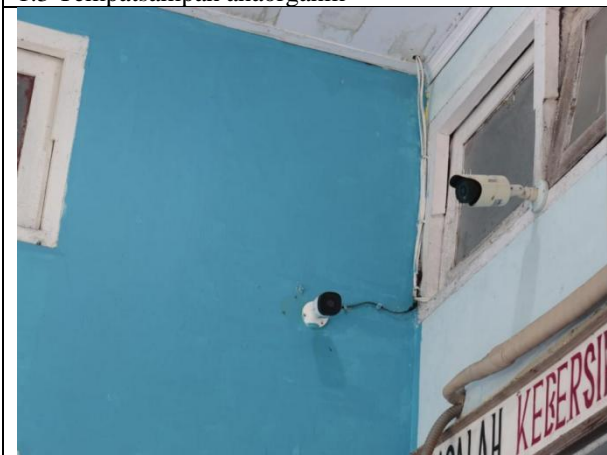
1.5 CCTV untuk pemantauan
