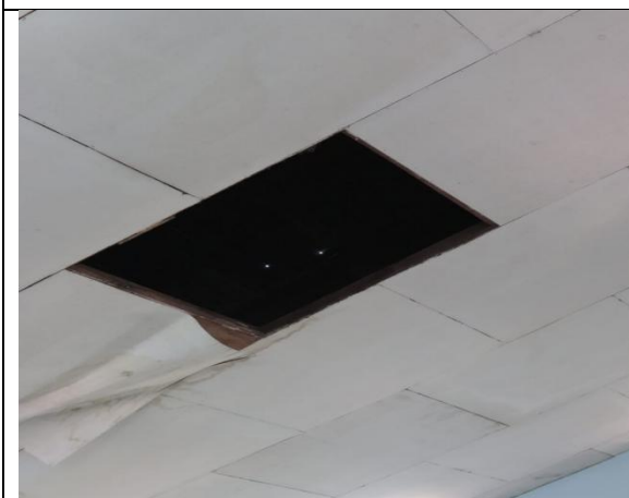
1.17 Atap rusak berbahaya bagi siswa
