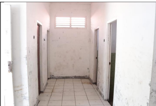
1.16 Ruang toilet kurang bersih
