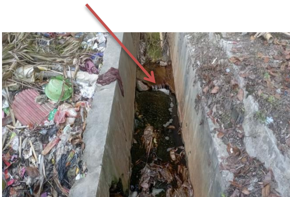
Gambar 5. Saluran Pembuangan limbah cair yang rusak
